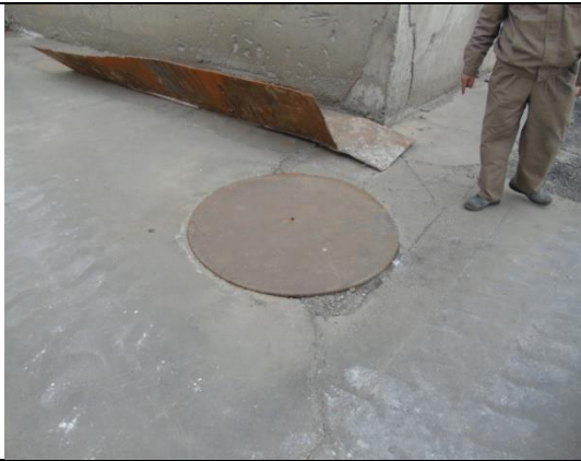
厂内废水管道
